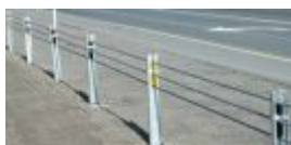
Τύπο καλωδιακών μπαρών (cable barrier)
